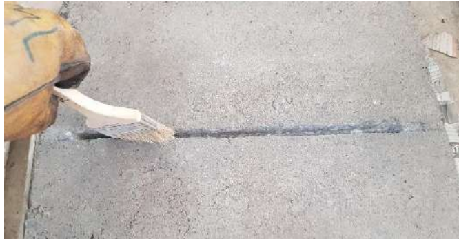
รูปที่ 2-59 จำลองสภาพความเสียหายจากรอยแตกบนแผ่นแอสฟัลต์คอนกรีต
